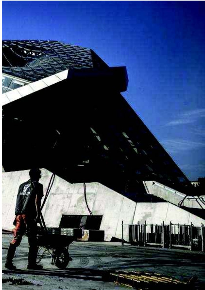
Le site du Musée des Confluences, toujours en chantier, à Lyon, le 29 octobre. JEFF PACHOU/AFIP
